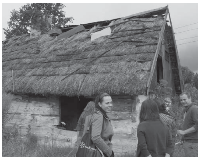
Chata parobka w Paproci - pomiary zachowawcze; budynek do rozbioru
